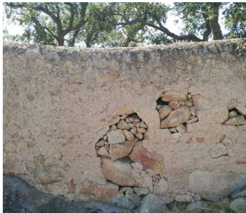
Masonry wall in Beirã, finished in a mortar which mixes lime and local earth Muro de alvenaria na Beirã, acabado com argamassa de cal e solo local Muro de mampostería en Beirã, acabado con mortero de cal y tierra local
