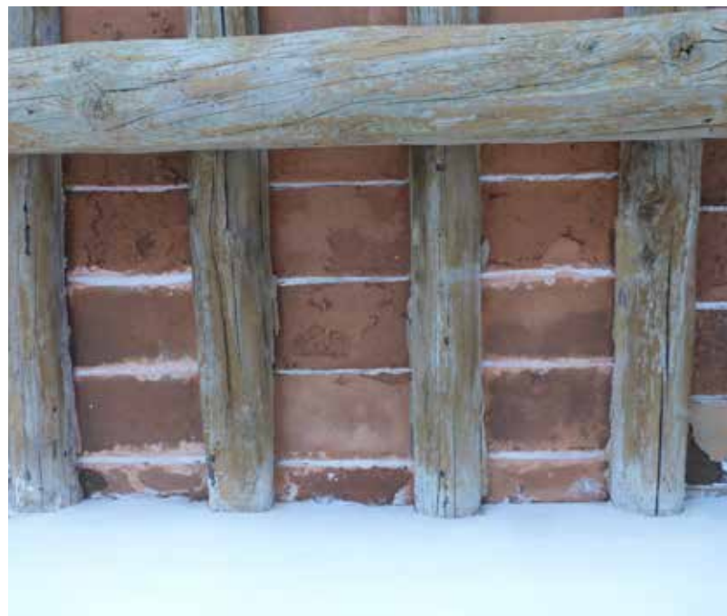
Wooden beams and ceramic tiles structure in Évora Vigas de madeira forjadas e elementos cerâmicos em Évora Forjado de vigas de madera y elementos cerâmicos en Évora
