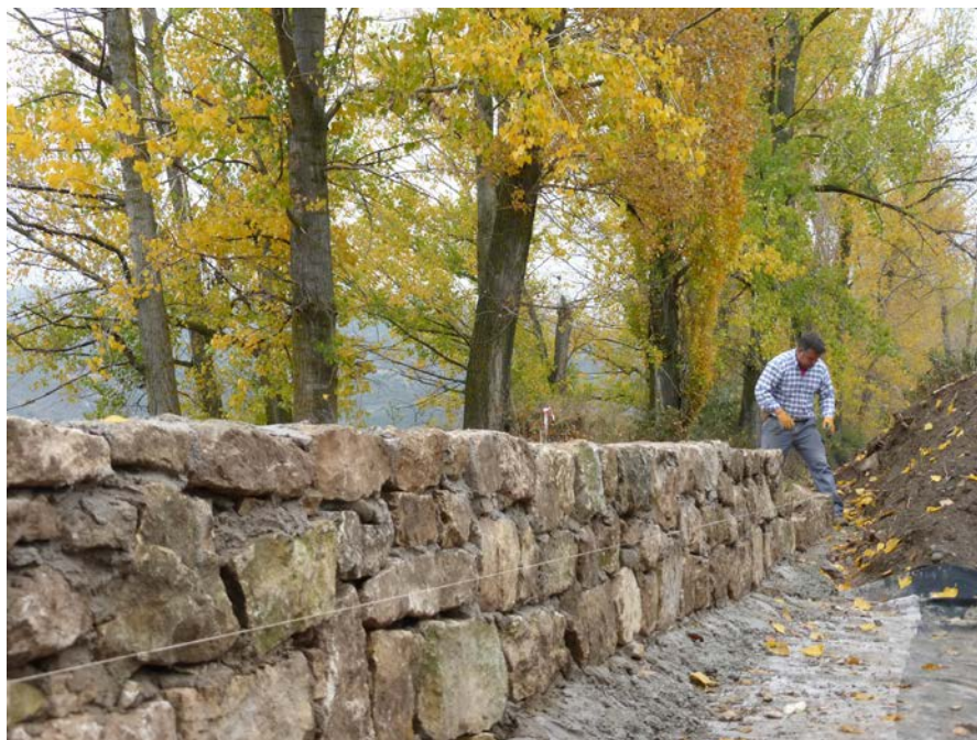
Ejecución de nuevos muros de mampostería y mortero de tierra y cal en el Canal de Cabarrús, Torremocha de Jarama (Madrid)
