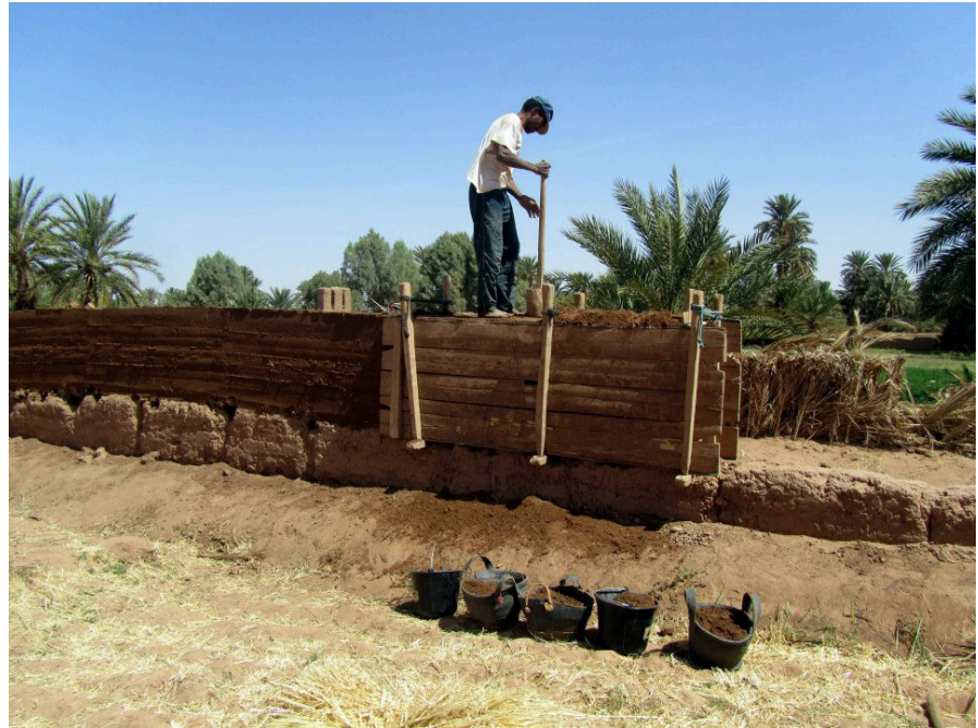
Reconstrucción de los muros de tapial de las huertas del ksar de Mhamid El Ghezlane (Zagora, Marruecos) por el equipo de Terrachidia
